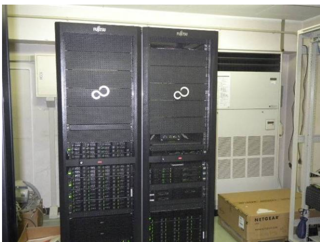
図9: 新レンタルサーバ(左の2つのラック)と空調機(右奥)
