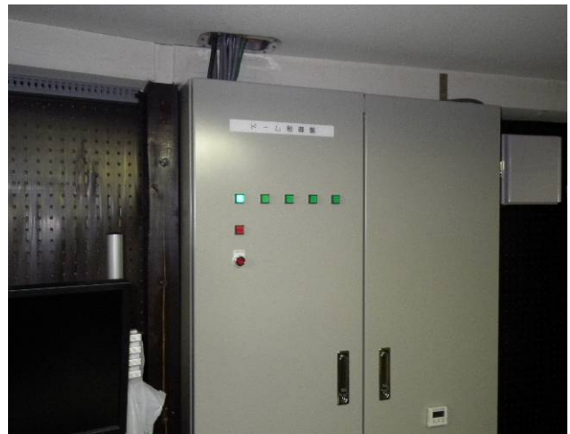
図 1 : PLC が収められている新ドーム制御盤。制御室に設置されている
